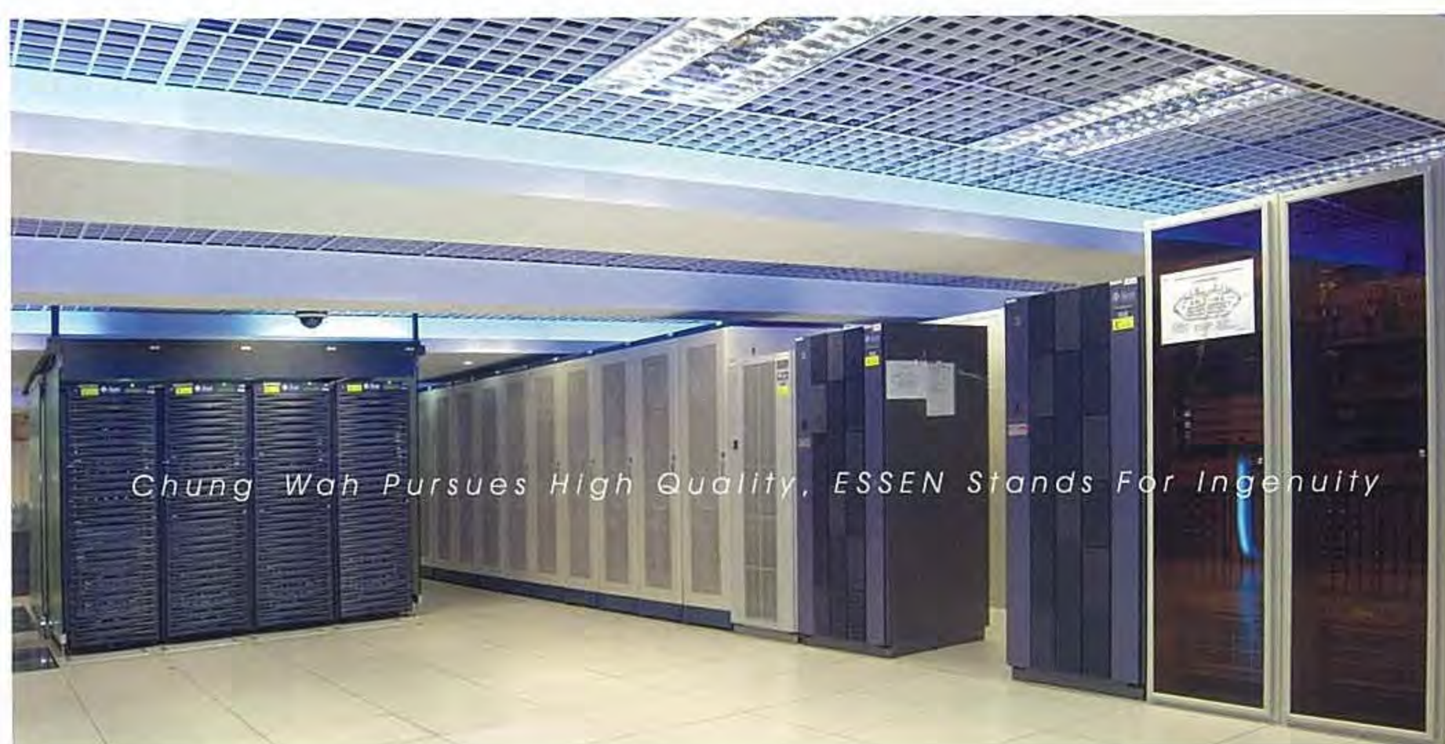
數據中心 Data Centre
