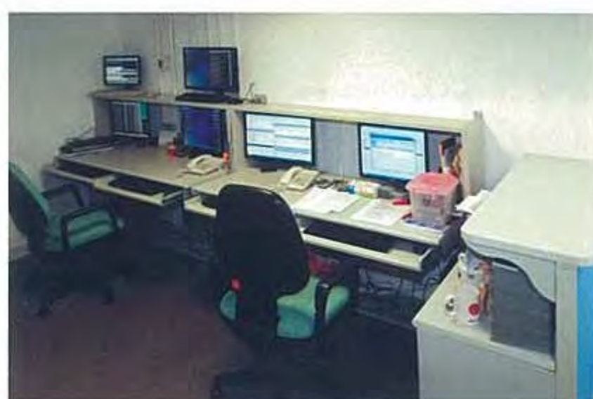
控制枱 Control Console
